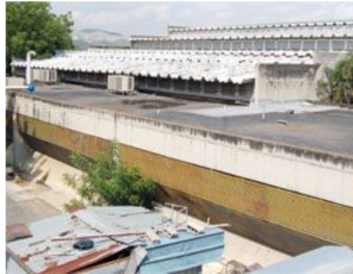
Las aulas están en penosas condiciones y azotadas por el hampa Foto: Daniel Arrieta
